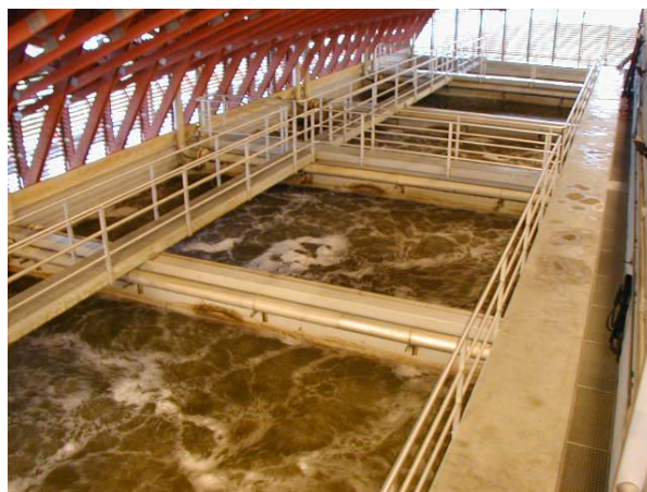
Nyborg Centralrenseanlæg, Biostyr Celler
